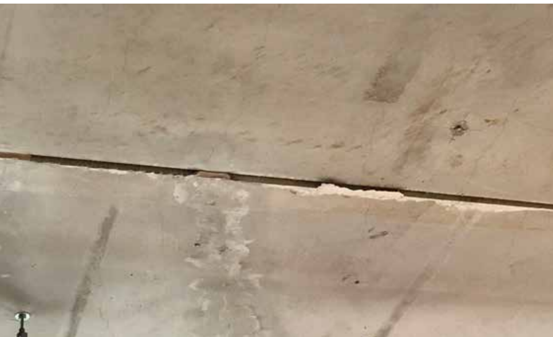
Zichtbaar gedelamineerde (verzakte) breedplaat voorafgaand aan de reparatie met het door-en-door anker.
